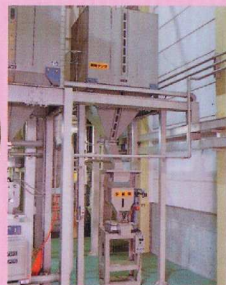
●調整タンク・計量機
