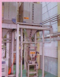
●調整タンク・計量機
